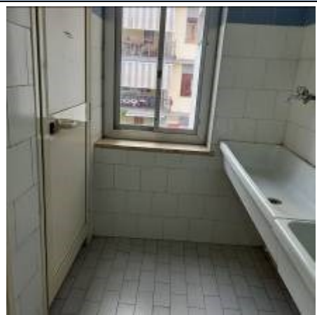
Prevedere al blocco apertura delle finestre con parapetti alti meno di 1 metro
