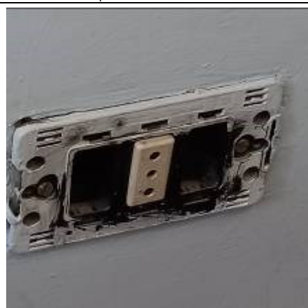
protezione delle prese elettriche danneggiate
