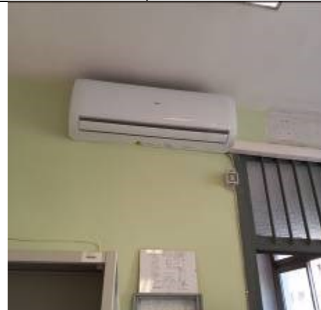
Provvedere alla pulizia e manutenzione dei filtri dei condizionatori
