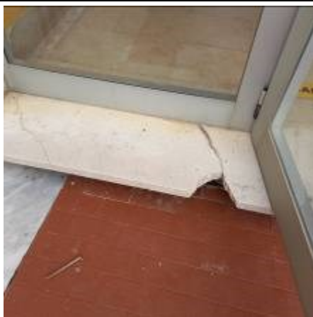
Segnalare con nastro colorato e cartelli il pericolo di caduta
